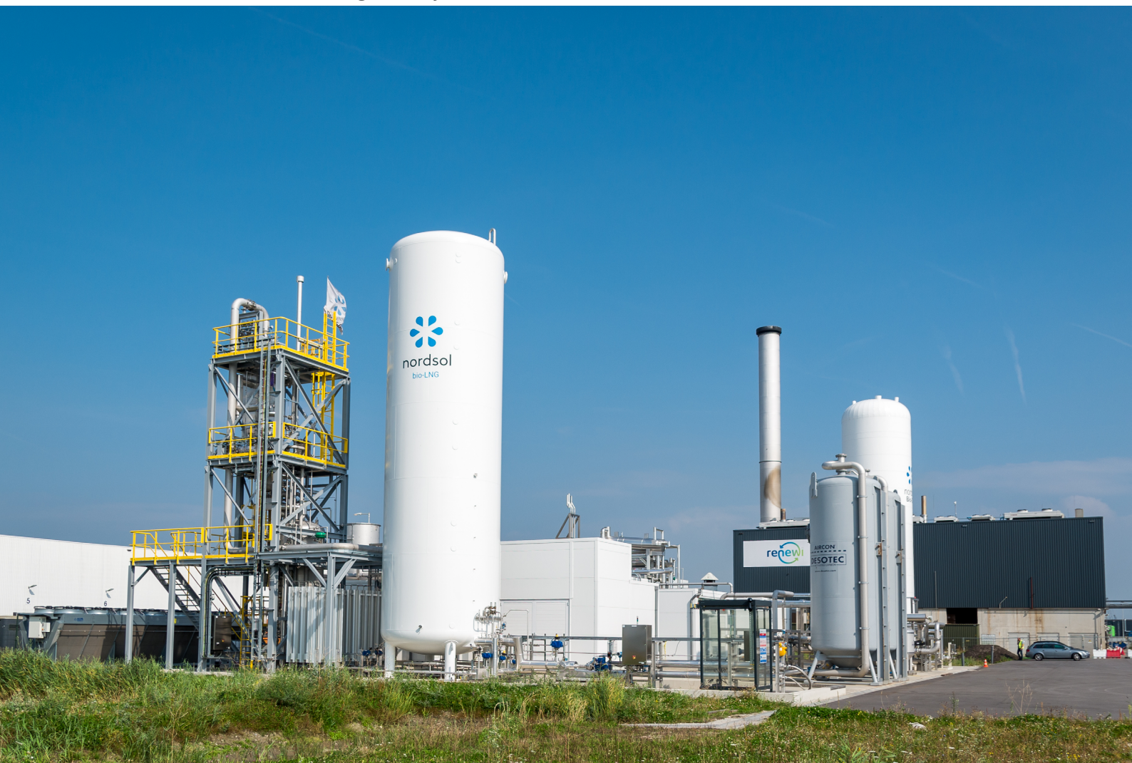
Instalacja skraplania biometanu do bioLNG
